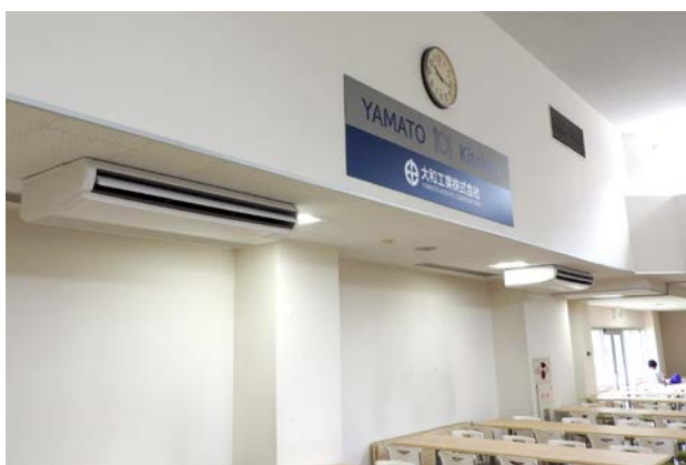
YAMATO Kitchenに設置されたエアコン
