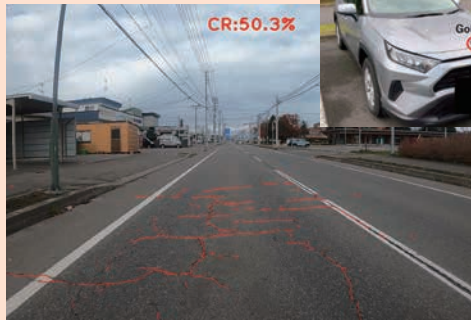
車載カメラで撮影した道路の画像。ひび割れを示す赤い線が、瞬時に認識される。このほか、わだち堀れや段差なども検知できる。
